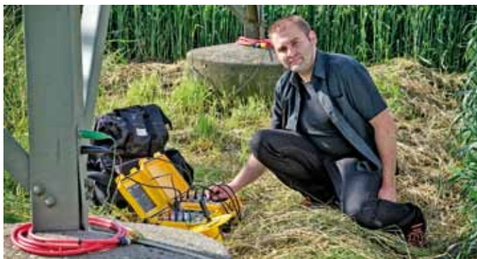
Abb.1: Messung an einem 380-kV-Mast
